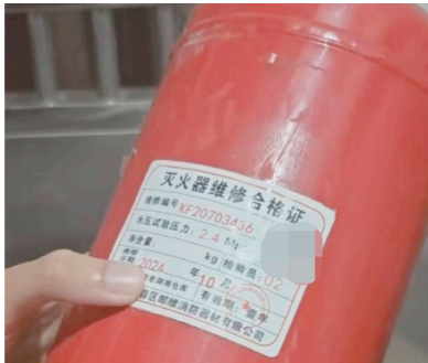
过期失效的灭火器。
