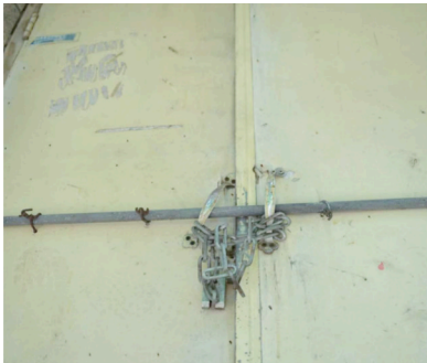
常闭式防火门被铁链锁住。
