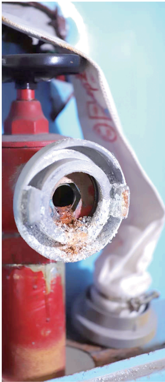
消火栓出水口已锈迹斑斑。组图/“潇湘调查”记者
