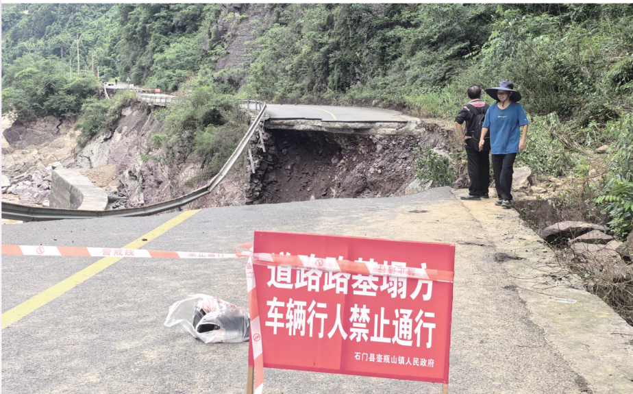
塌陷的路段。组图/记者李姝 於广强 曹伟
